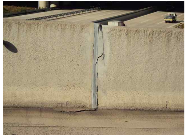
방호벽 S1(A1) 접속부 파손(0.2×1.0)
