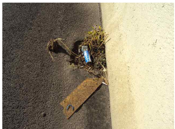
배수시설 S1 배수구 막힘(1EA)
