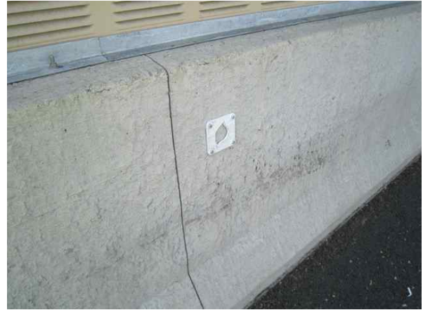
방호벽 S1 텔리네이트 파손(1EA)
