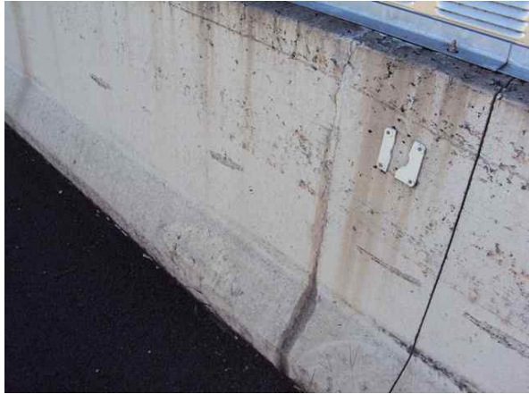
방호벽 S1 균열(Cw=0.3mm이상)
