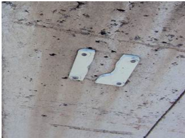
방호벽 S1 텔리네이트 파손(1EA)
