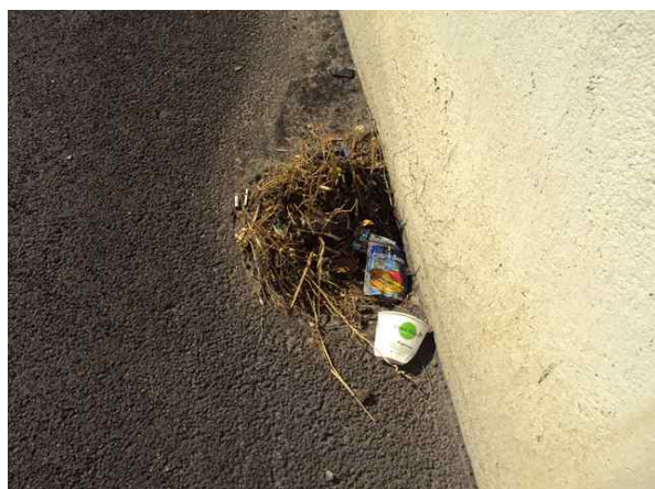
배수시설 S1 배수구 막힘(1EA)
